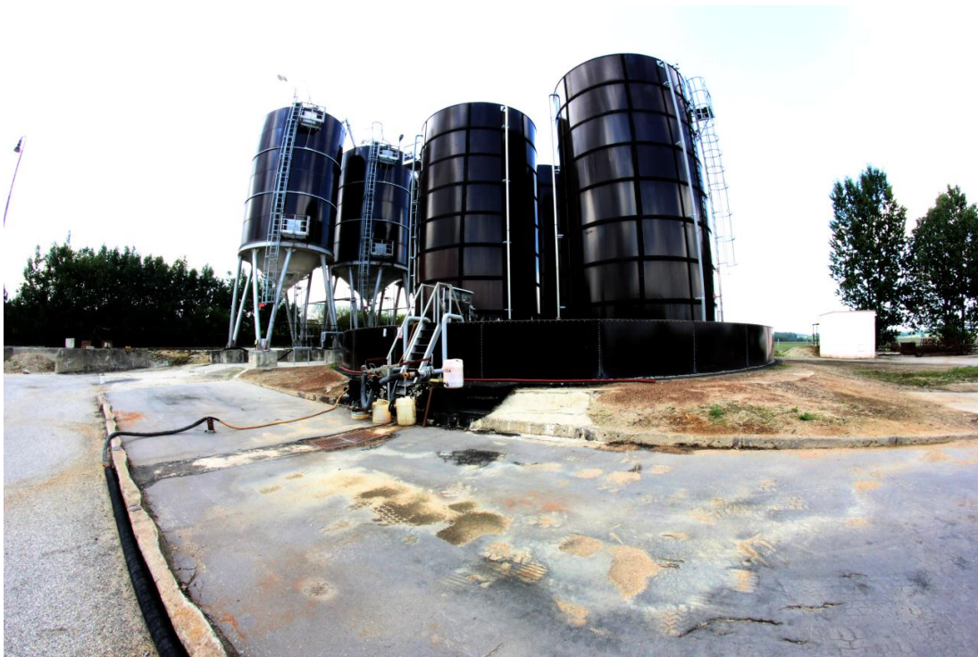
Obrázek 30 Nadzemní nádrže (vpravo) a čerpací místo (v popředí) kapalných hnojiv [zdroj: autor]
