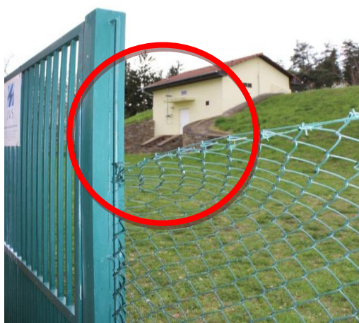
Obrázek 30: VDJ Vodňany, poškozený plot, Zdroj: Vlastní výzkum
