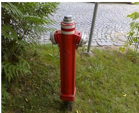
Obrázek 7 – Nadzemní hydrant, zdroj: http://www.pozary.cz/clanek/8314-lov-na-nadzemni-hydranty-1-dil/
