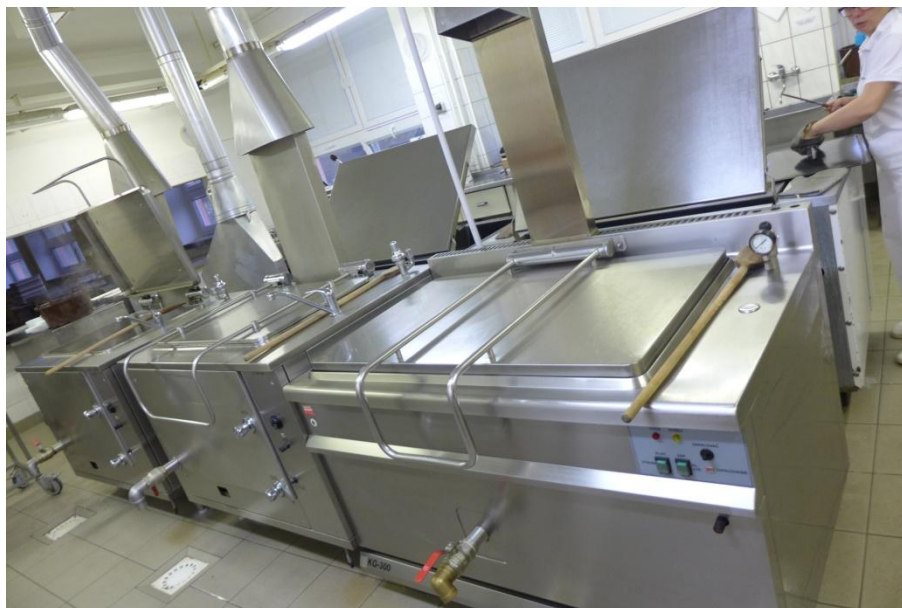
Obrázek č. 36 ZŠ a MŠ Pražská Znojmo – varné kotle, smažicí pánve
