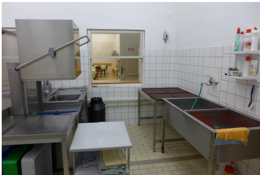
Obrázek č. 22 Kuchyně ZŠ a MŠ Jevišovice – dvojdřez, myčka na nádobí
