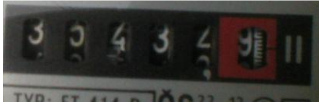
Obrázek 18: Příklad chyby: nedokonale přetočené hodnoty na elektroměru
