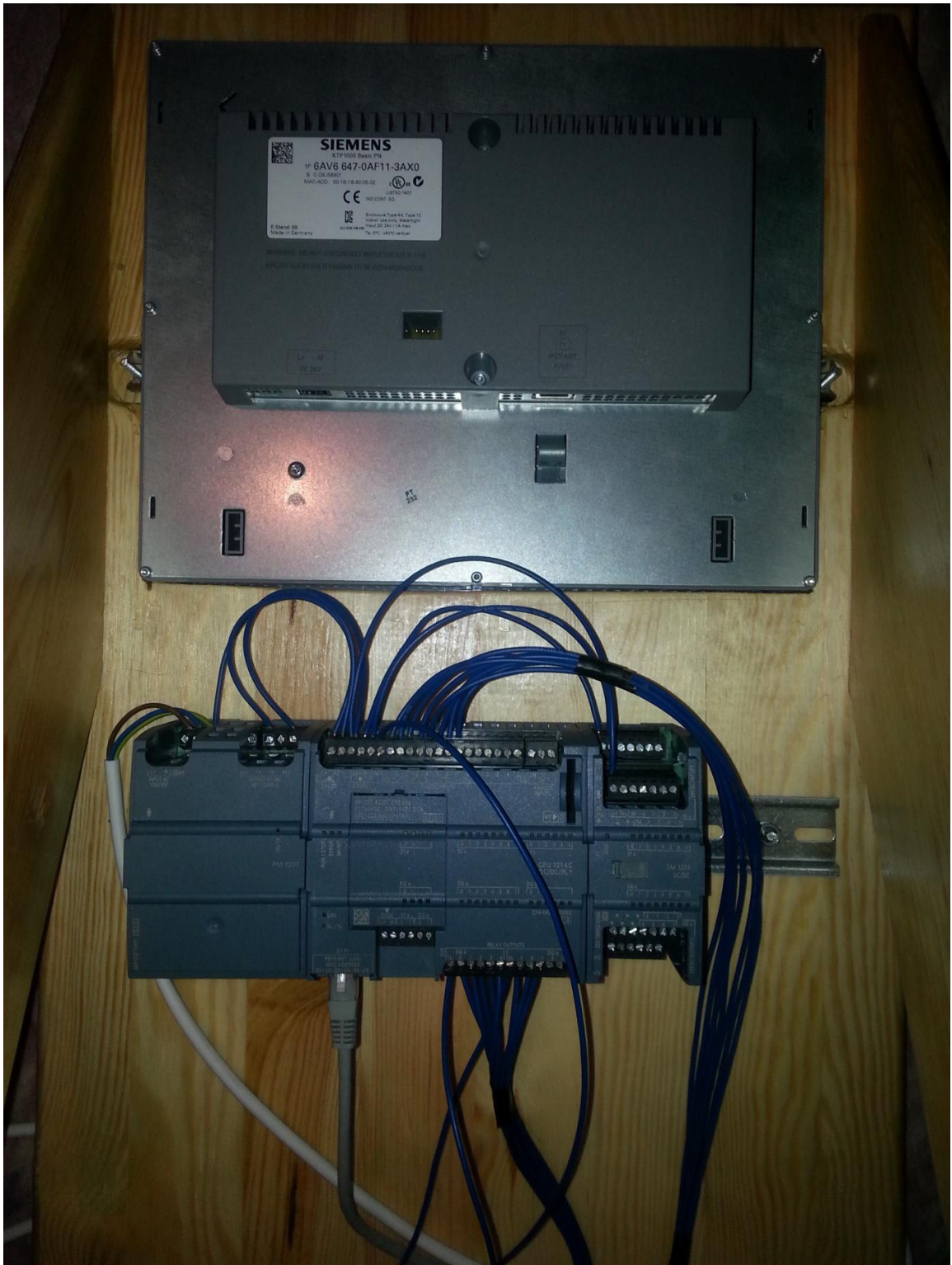
Příloha 2: Fotografie sestavy Simatic ve dřevěné zástavbě-zezadu
