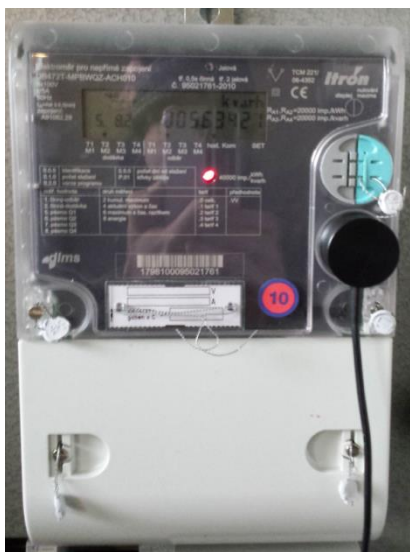
Obrázek 12: Elektroměr DC4/6Q s přiloženou optickou sondou.
