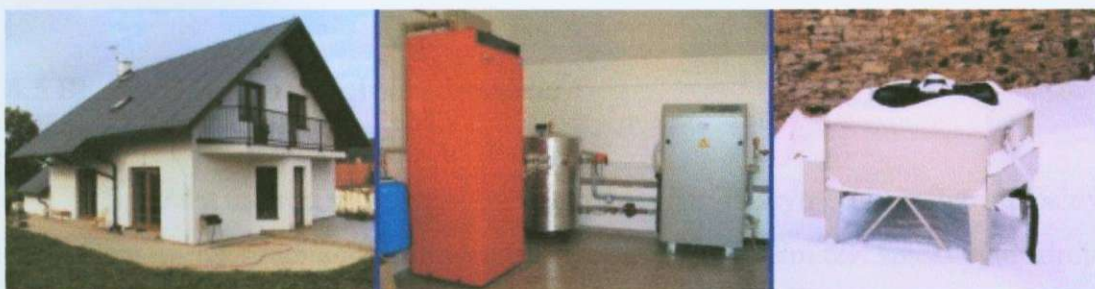
obr. 15: vytápěný objekt, tepelné čerpadlo vnitřní část a tepelné čerpadlo venkovní část
