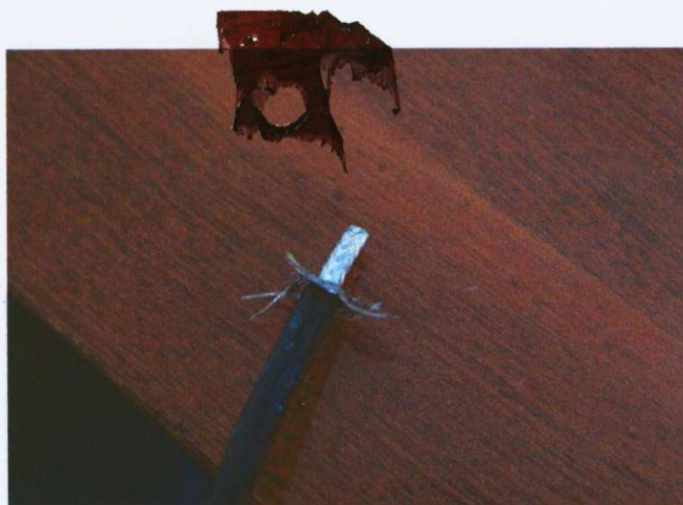
Obr. 35: Přihnuté stínění kabelu.
