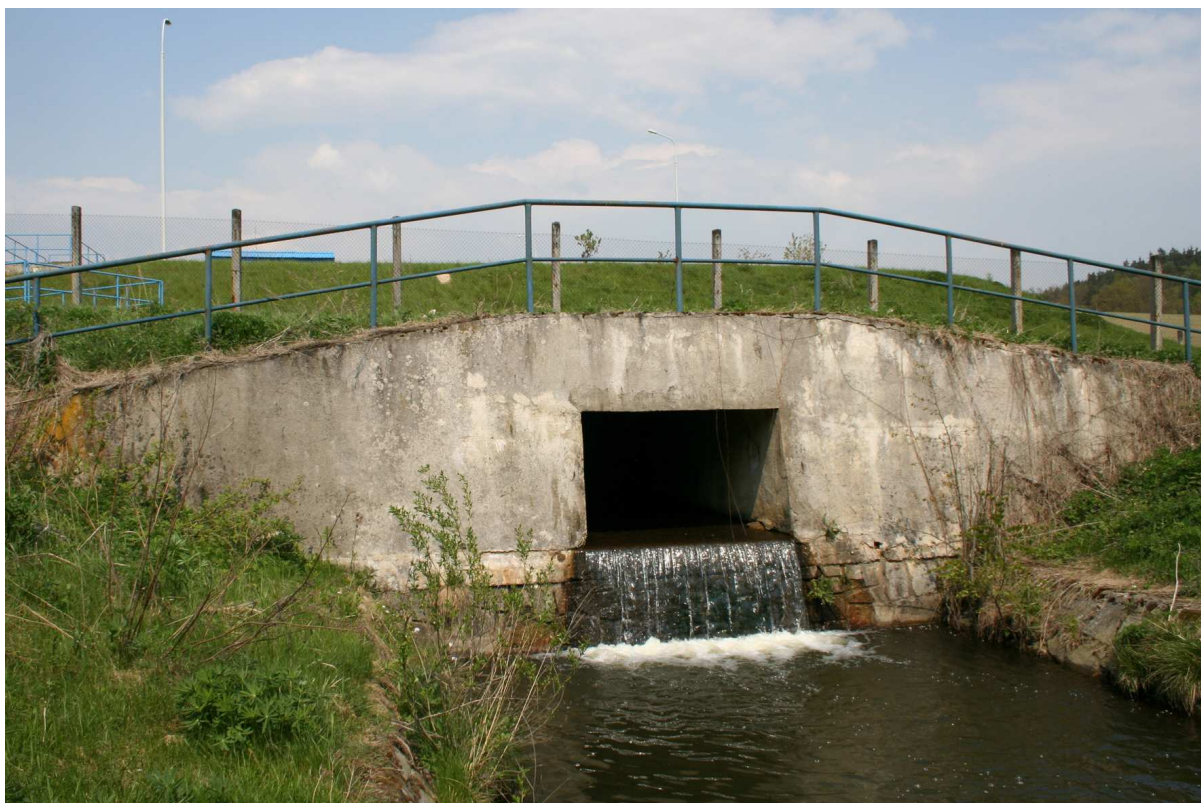
Obr. č. 34: Odběrové místo č. 12 – Výtok z ČOV Býšov
