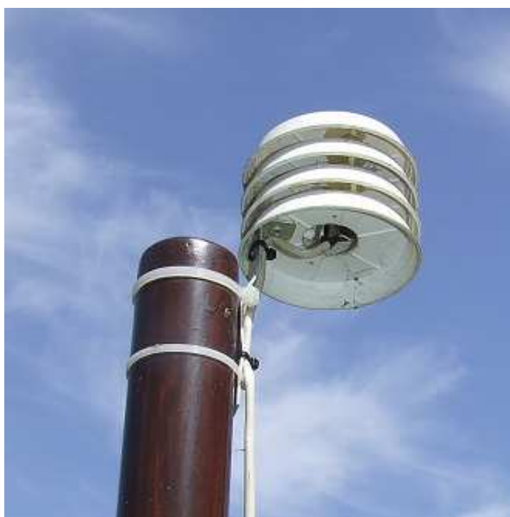
Obr. č. 13: Detail radiačního krytu, uvnitř čidlo venkovní teploty a vlhkosti
