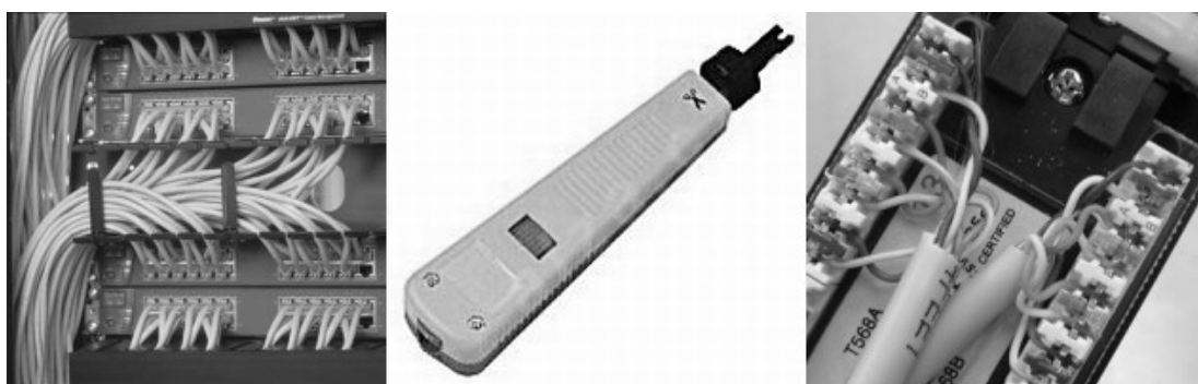
Obrázek 7 - Patch panel, narážecí zařízení, patch panel - zadní strana
