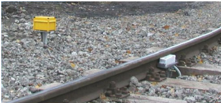
4411-1: Pohled na počítač náprav a přípojovací krabici
