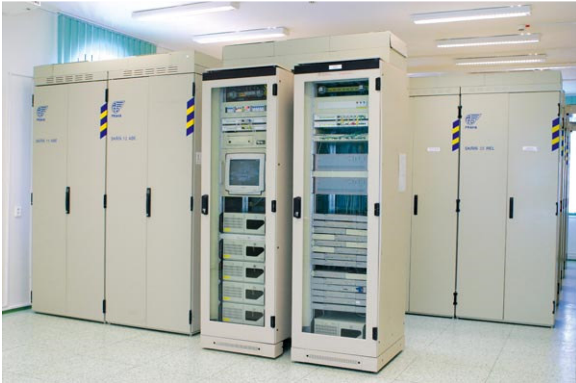
74-1: Technologické počítače výkonové úrovně systému ESA 11 (AŽD a.s.)
