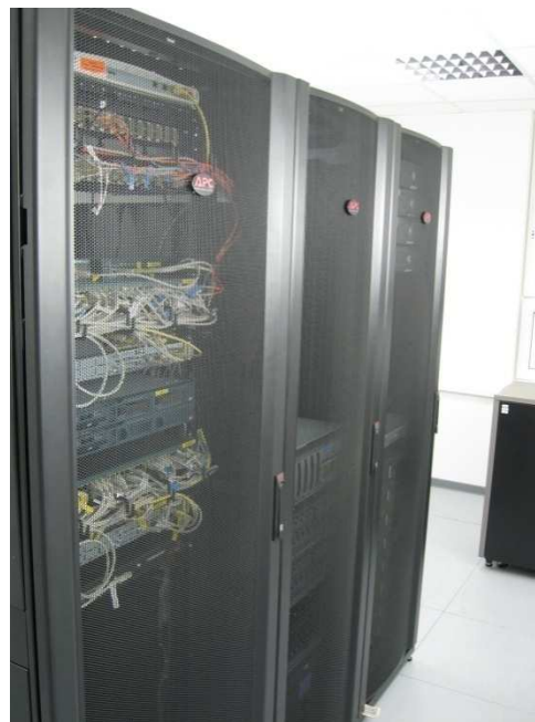
Obr. č. 9 – Rackové skříně v primární místnosti
