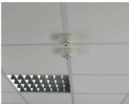
Obr. č. 8 – Stropní kouřové hlásiče
