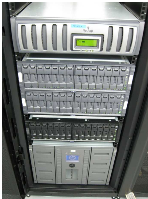
Obr. č. 19 – Diskové pole NetApp
