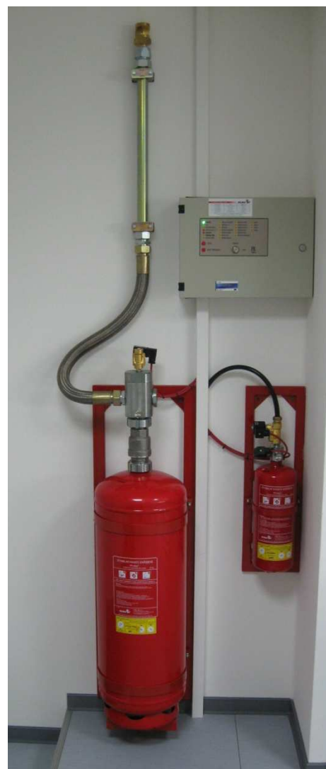
Obr. č. 7 – Požární nádrže s hasící látkou HFC 236fa
