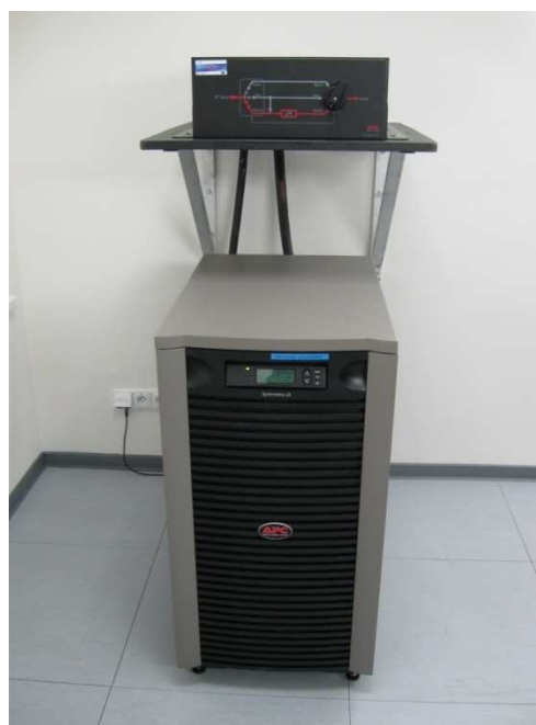
Obr. č. 10 – Centrální UPS zařízení
