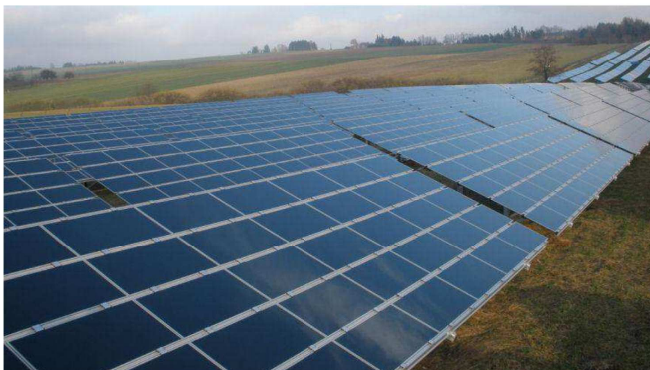
Obr. č. 9 Fotovoltaická elektrárna Lukavice, instalovaný výkon 1 595 kWp, převzato z [15]
