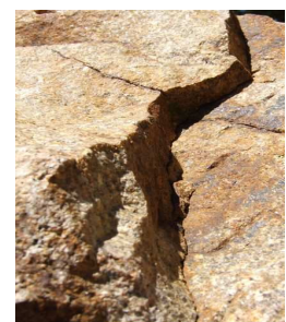
Obr.34 Puklina, vzniklá v důsledku mechanického zvětrávání.
