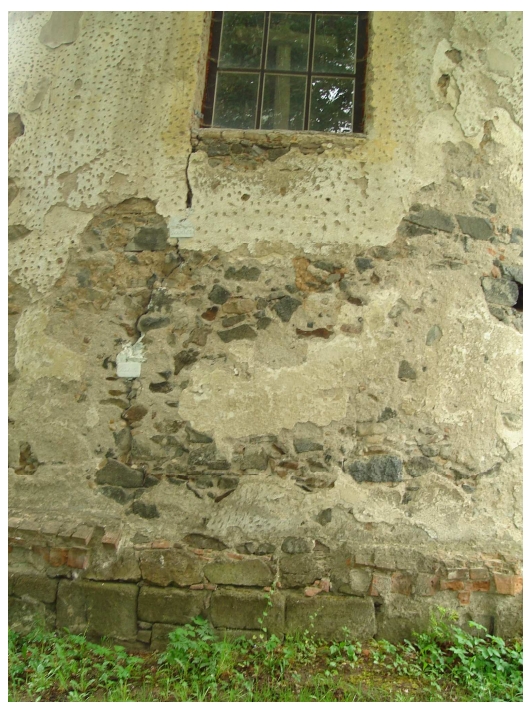
Detail omítky, východní strana
