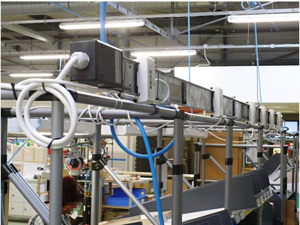
Detail kanalisového rozvodu el. energie na lince
