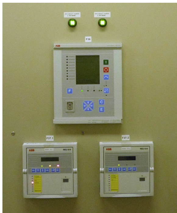
Obrázek 14 - Pole 2BJGA1 po záměně čelní pohled
