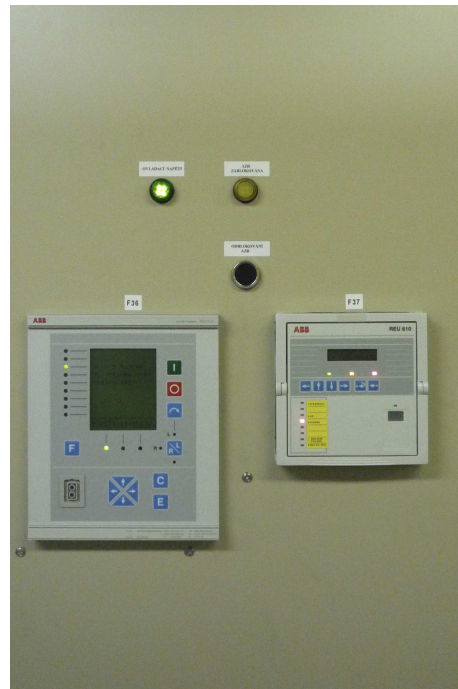
Obrázek 16 - Pole 2CA02GA1 po záměně čelní pohled
