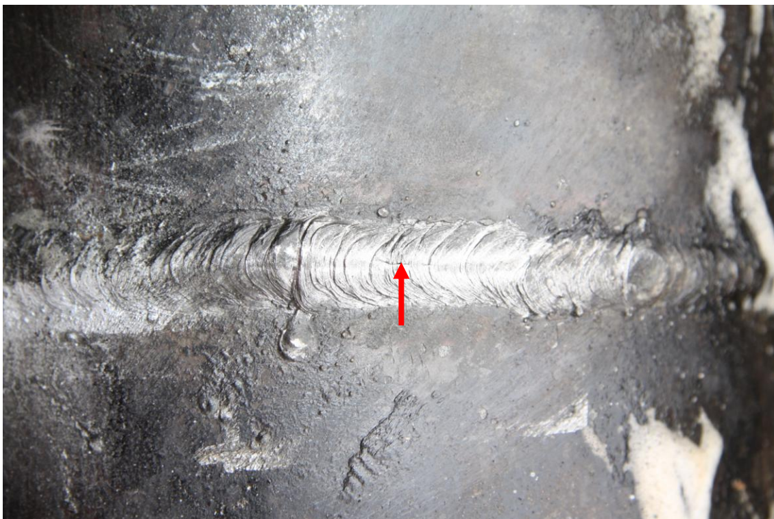
Obrázek 7 - Prasklý svar na spoji potrubí
