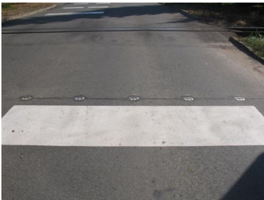
Obrázek č.6 - Železniční přejezd Nová Včelnice – světelná závora – detailní pohled 60
