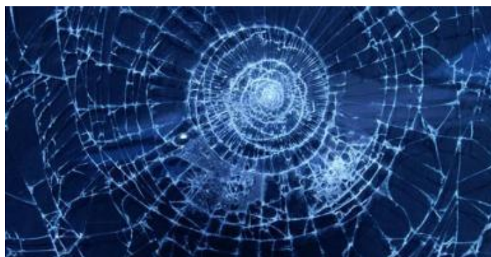
Obr. č. 7: Příklad poškození okna s nainstalovanou bezpečnostní fólií. Zdroj: www.next.cz
