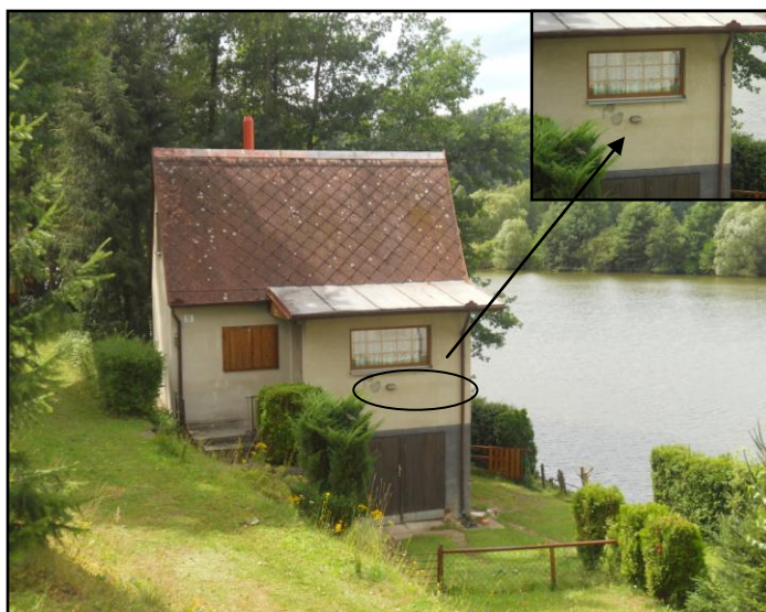
Obr. 15: Linie, která ukazuje část, po kterou byla chata zatopena v chatové osadě JC10E4 Týn nad Vltavou - Na Soutoku.
