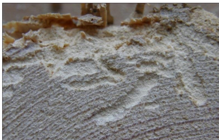
Obr. 44 – Požerky tesaříka krovového
