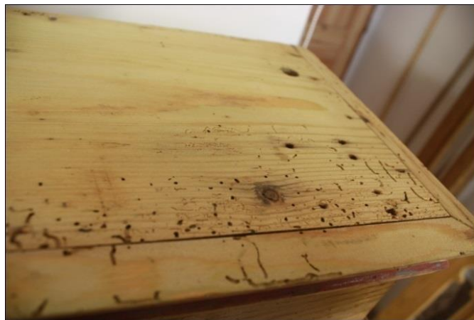
Obr. 52 – Poškození červotoči, převzato a upraveno z [20]
