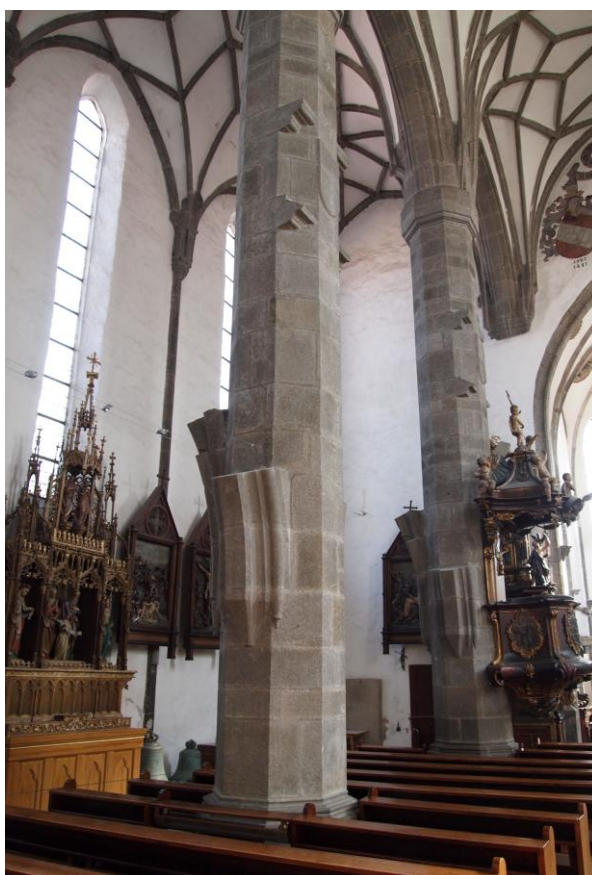
34. Pohled na pilíře levé boční lodi, patrné osekane klenební patky a římsy.
