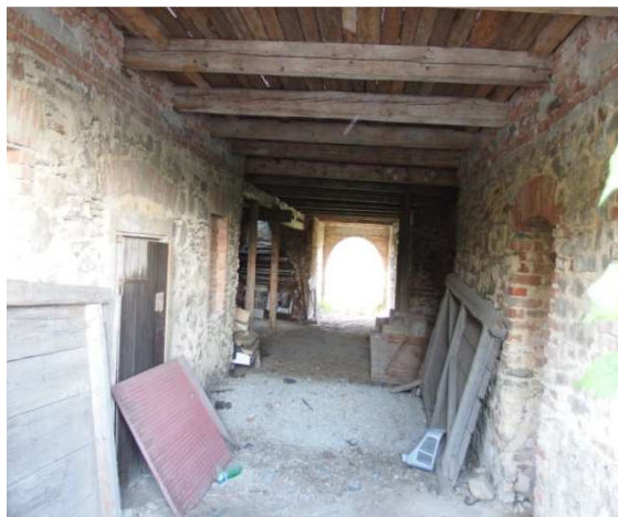
Obr. 3.1.8 Holkov přeprážní stanice interiér
