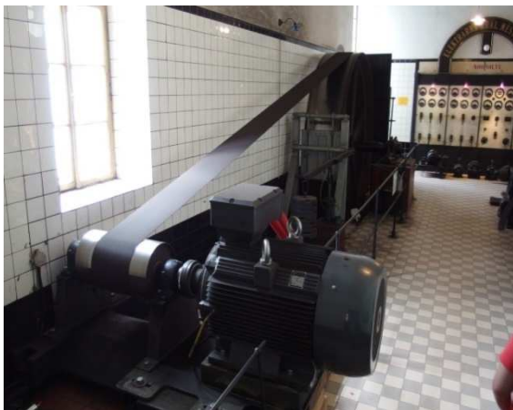
Obr. 4.4.6 Detail soustrojí s alternátorem
