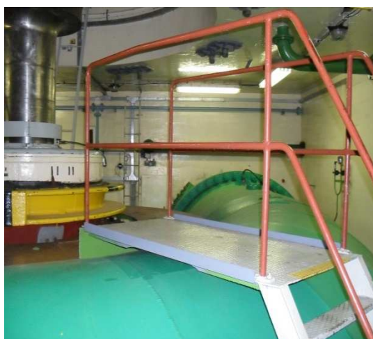
Obr. 5.2.3.7 Přívodní potrubí k turbíně
