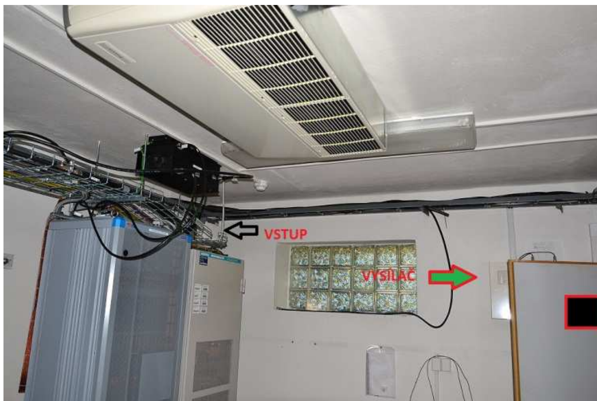
Obr.9.7 Technologická místnost na vysílači Libín
