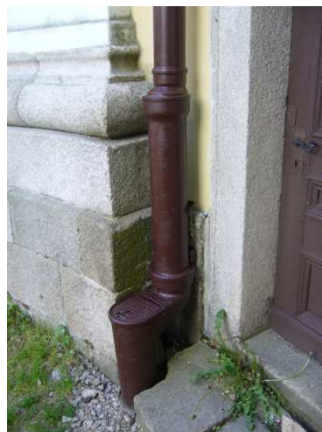
Obr. 39 Detail keše na okapu
