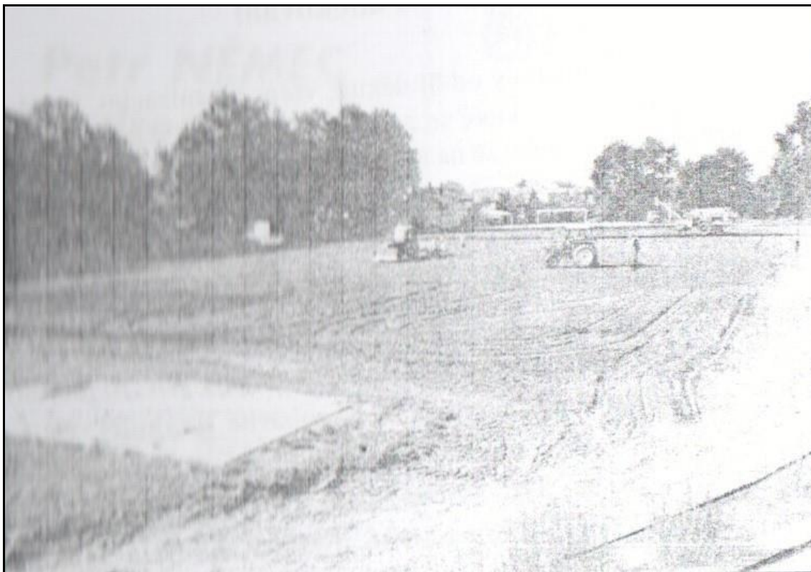
Příloha č. 13. Výstavba zatravnění plochy stadionu v Telči na jaře 1997, Fotografie převzata z Fabeš, R. (1999). Fotbalový oddíl Sk Telč.
