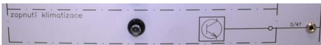
Obr. č. 65 Spínač klimatizace s možností měření elektrických veličin
