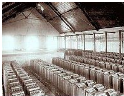
Obr. 61: Křížíkova místnost s akumulátory
