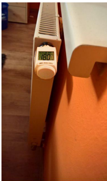
Obrázek 11 - Termostatická hlavice eQ-3 MAX!+ nainstalována na radiátor
