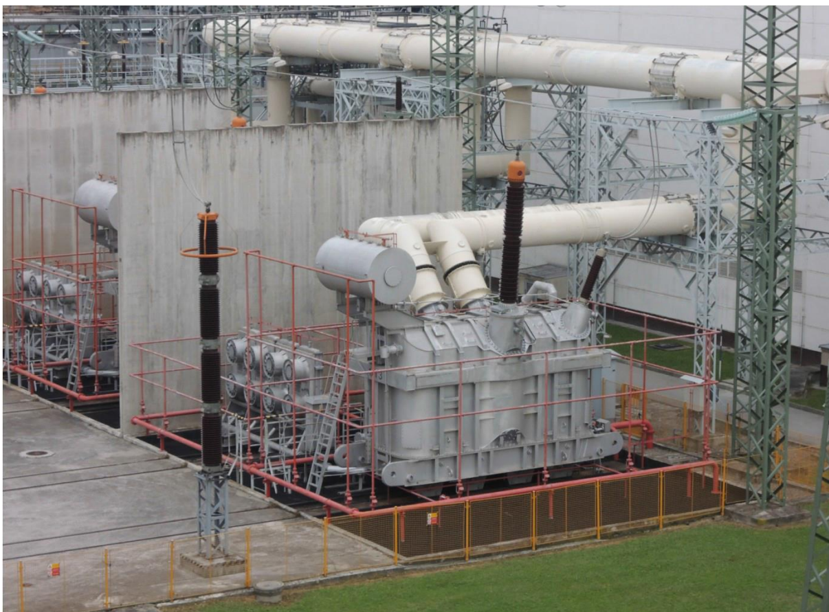
Obrázek 7: Pohled na třetí a druhou jednotku blokového transformátoru 1.HVB [7]
