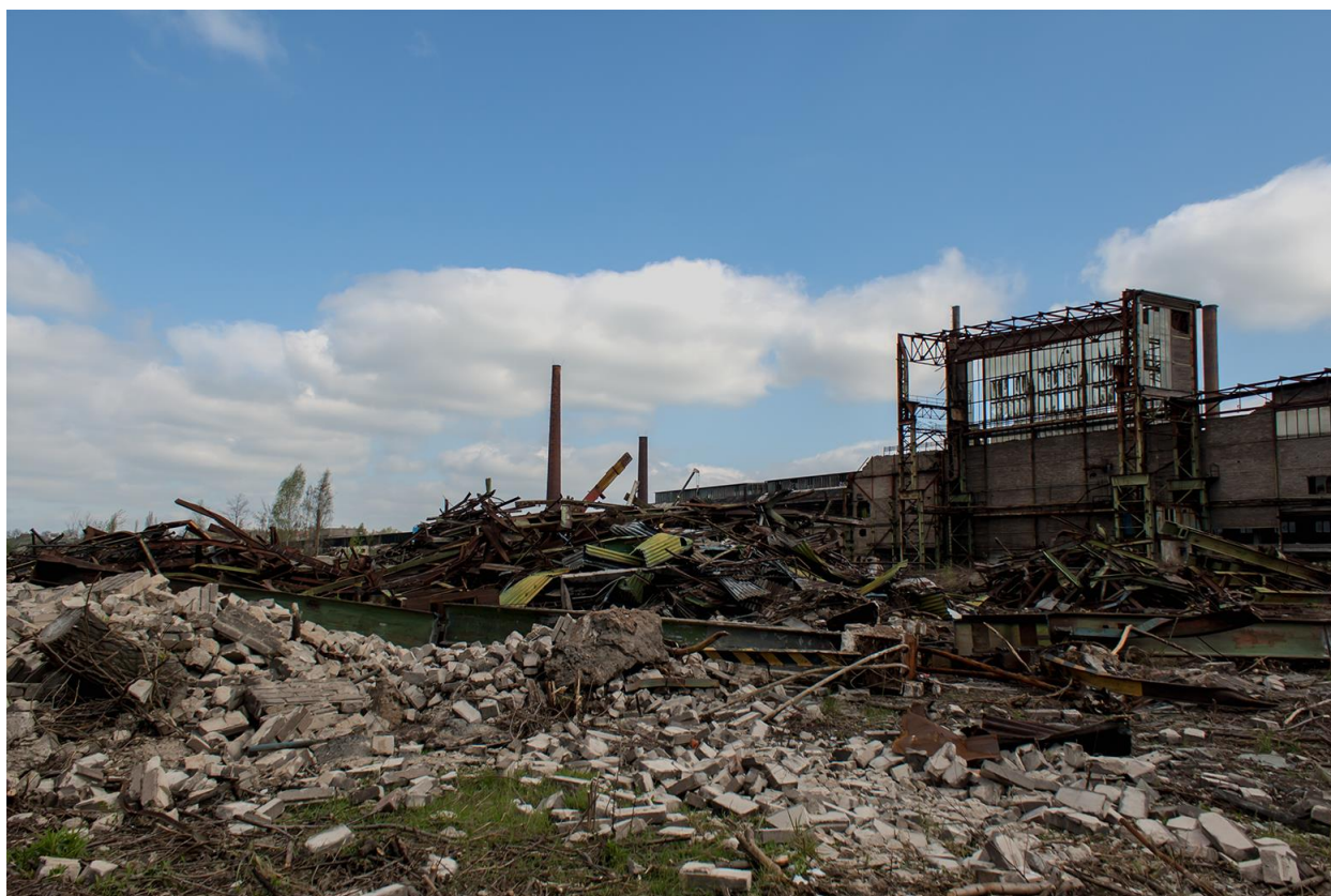
Obrázek 4: Zřícená část bývalé válcovny
