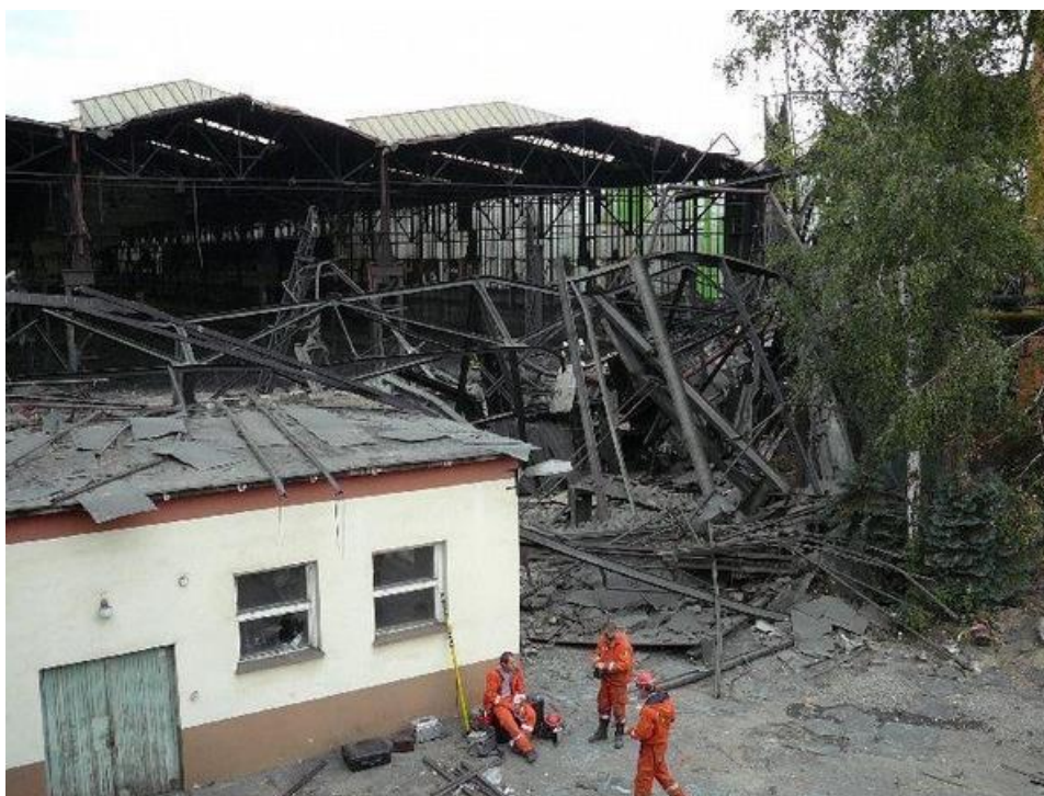
Obrázek 5: Zřícená část objektu válcovny Poldi (33)
