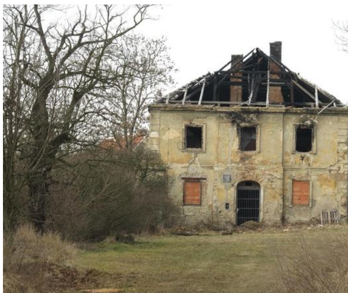
Obrázek 33: Vyhořelá část hospodářské budovy
