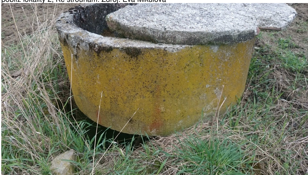
Foto č. 14: Stav druhé revizní šachtice na hlavním odvodňovacím zařízení poblíž lokality 2, Ke strouhám. Zdroj: Eva Mikulová
