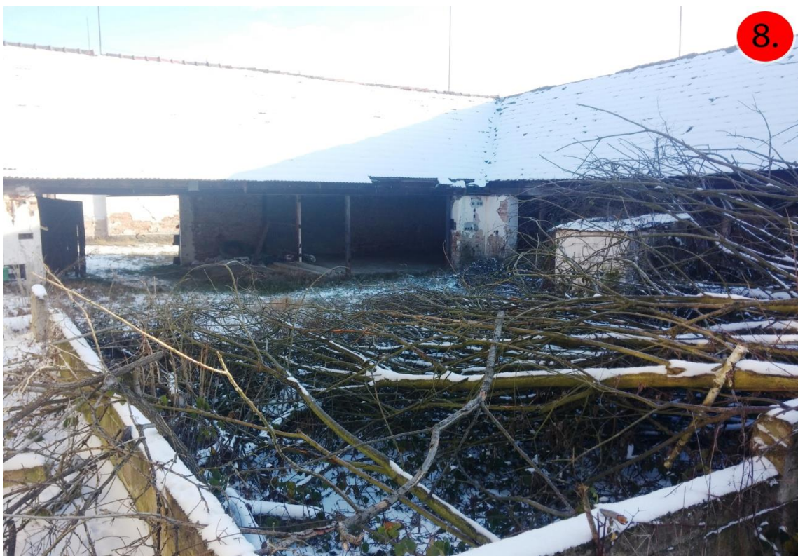
Obr. č. 14 – Jihovýchodní pohled na celou stodolu, kde si uprostřed dvora můžeme všimnout suchého WC (Zdroj: vlastní šetření)
