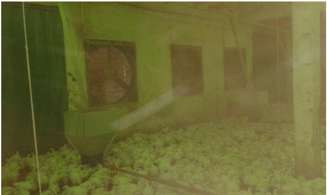
Foto 2 – Čelní ventilátory zevnitř objektu
