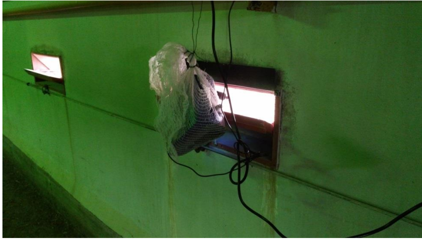
Obrázek 12 – Umístění přístroje ve stáji vstupu vzduchu, Zdroj: autor
