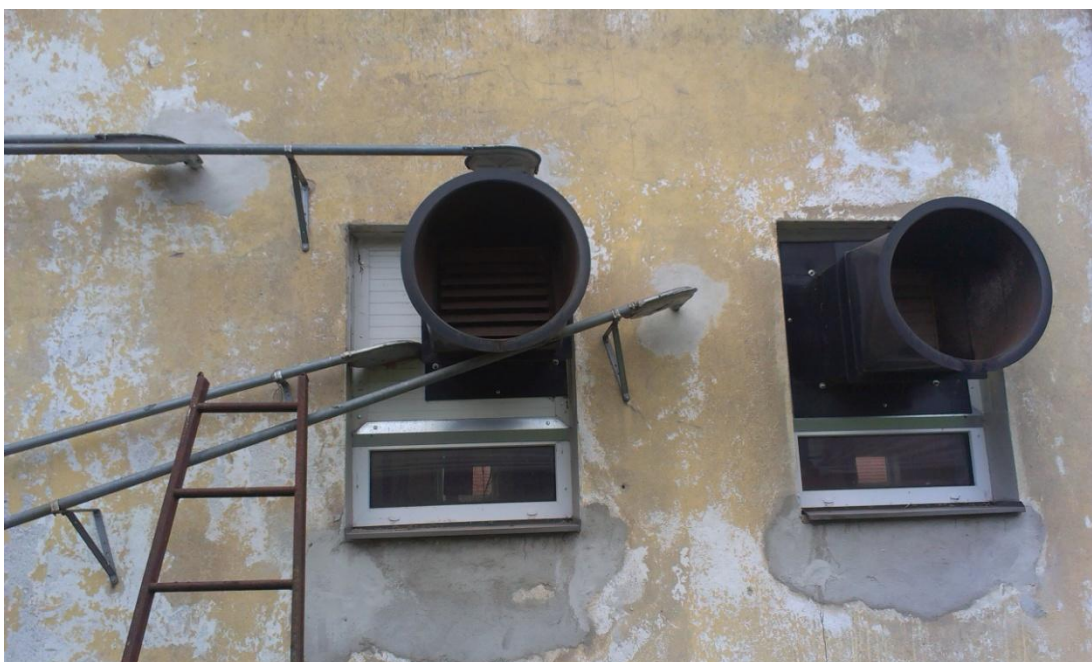
Obrázek 32 – Venkovní vyústění ventilátorů
