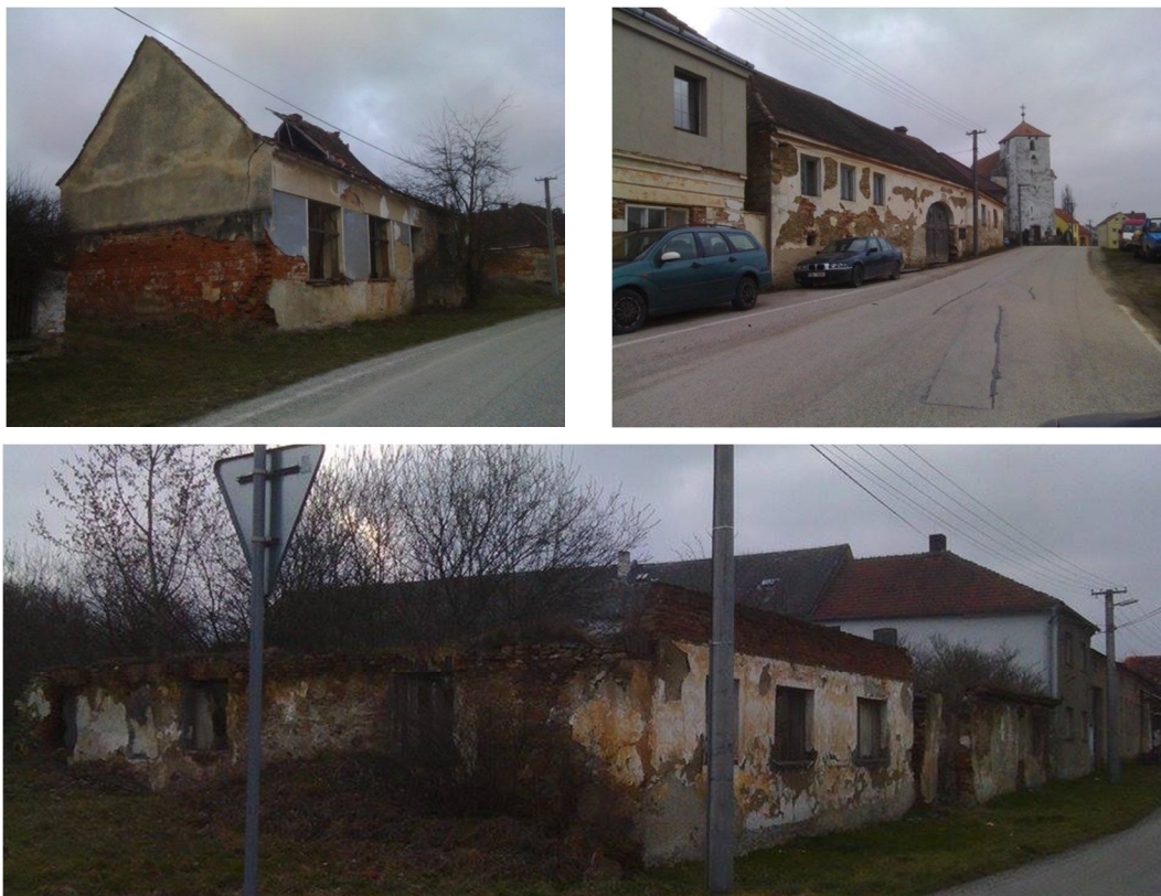
Obr. č. 8, 9, 10: Návesní domy v dezolátním stavu.
