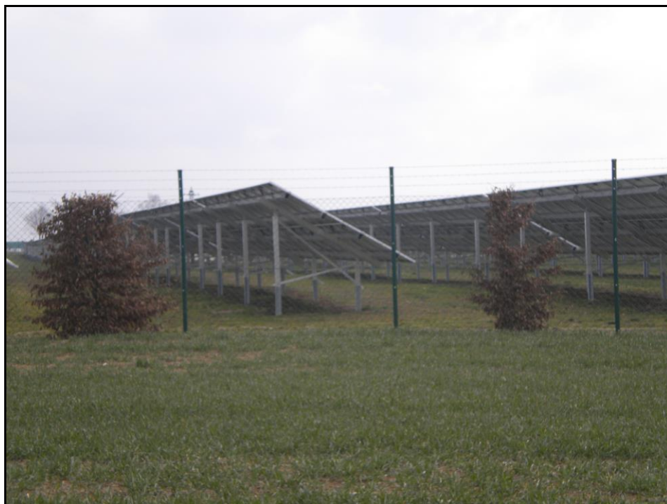
Fotografie č. 11 Erozní linie č. 1
