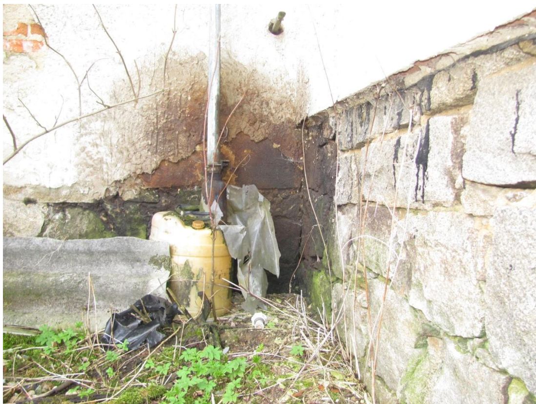
Foto č. 16 – pohled na vlhký kout u vodovodního potrubí (zdroj: vlastní fotografie)
