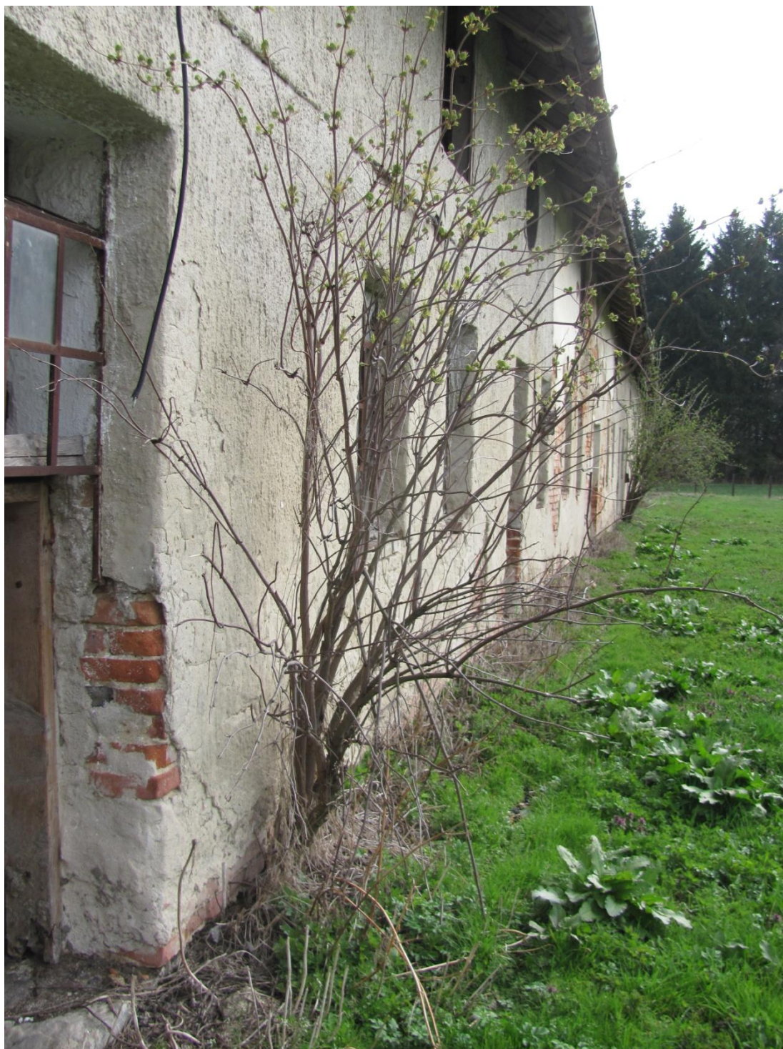
Foto č. 18 – pohled na dřeviny vyrůstající z obvodové stěny (zdroj: vlastní fotografie)
