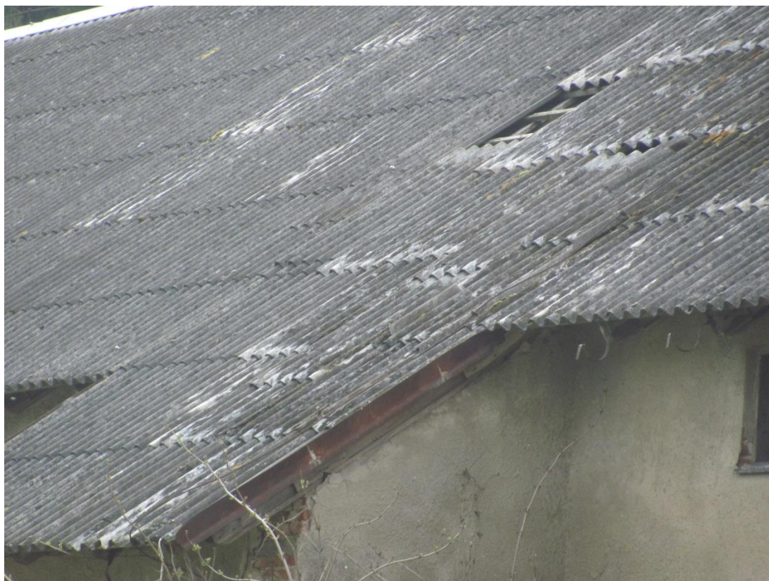
Foto č. 23 – pohled na porušenou střešní krytinu z azbestocementových desek (zdroj: vlastní fotografie)
