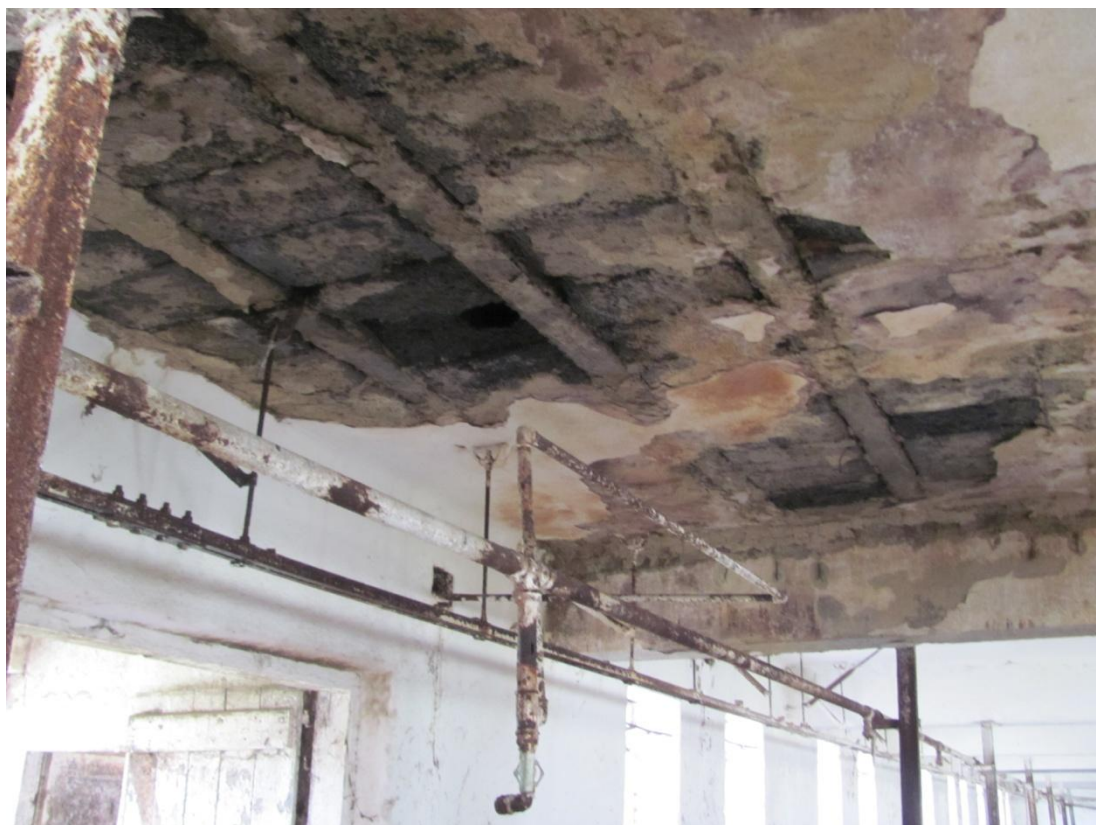
Foto č. 20 – pohled na velmi porušené stropní vložky, nad kterými chybí poměrně značná část střešní desky (zdroj: vlastní fotografie)
