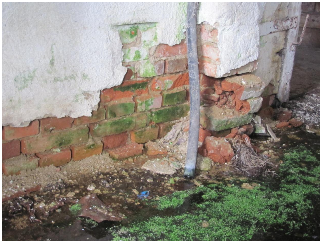
Foto č. 21 – pohled na vlhké zdivo (zdroj: vlastní fotografie)
