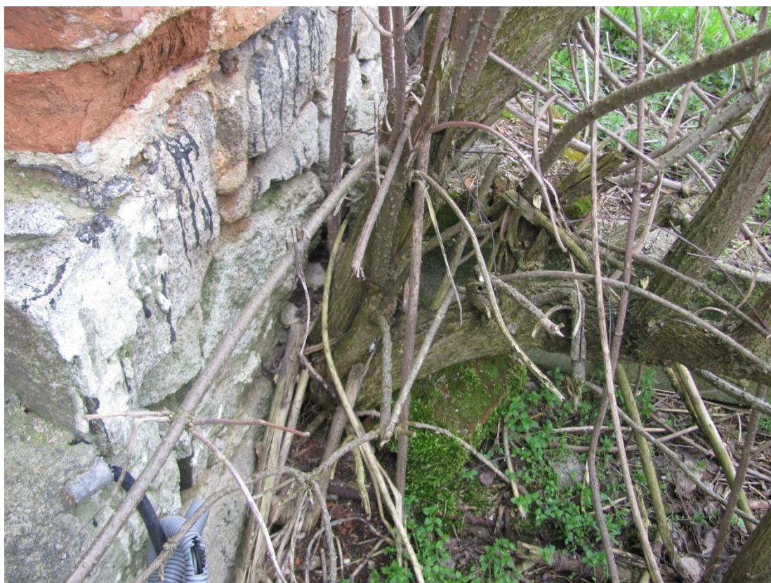
Foto č. 17 – pohled na keř vyrůstající ze základové stěny (zdroj: vlastní fotografie)
