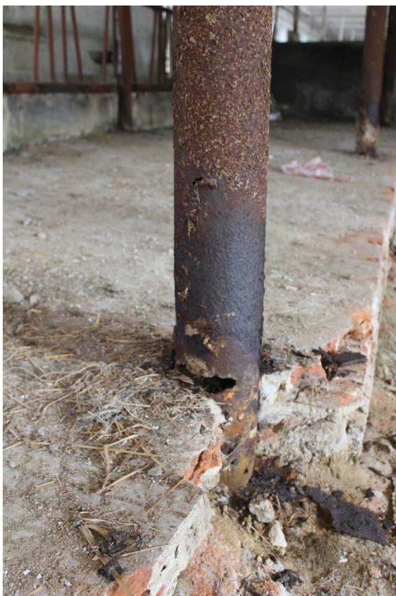
Obrázek 9 Zkorodované nosné sloupy ve stáji (Zdroj: vlastní šetření)
