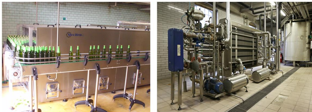
Obrázek 13: Ukázka instalace tunelového pasteru (vlevo) a průtokového pasteru (vpravo) v provozu
