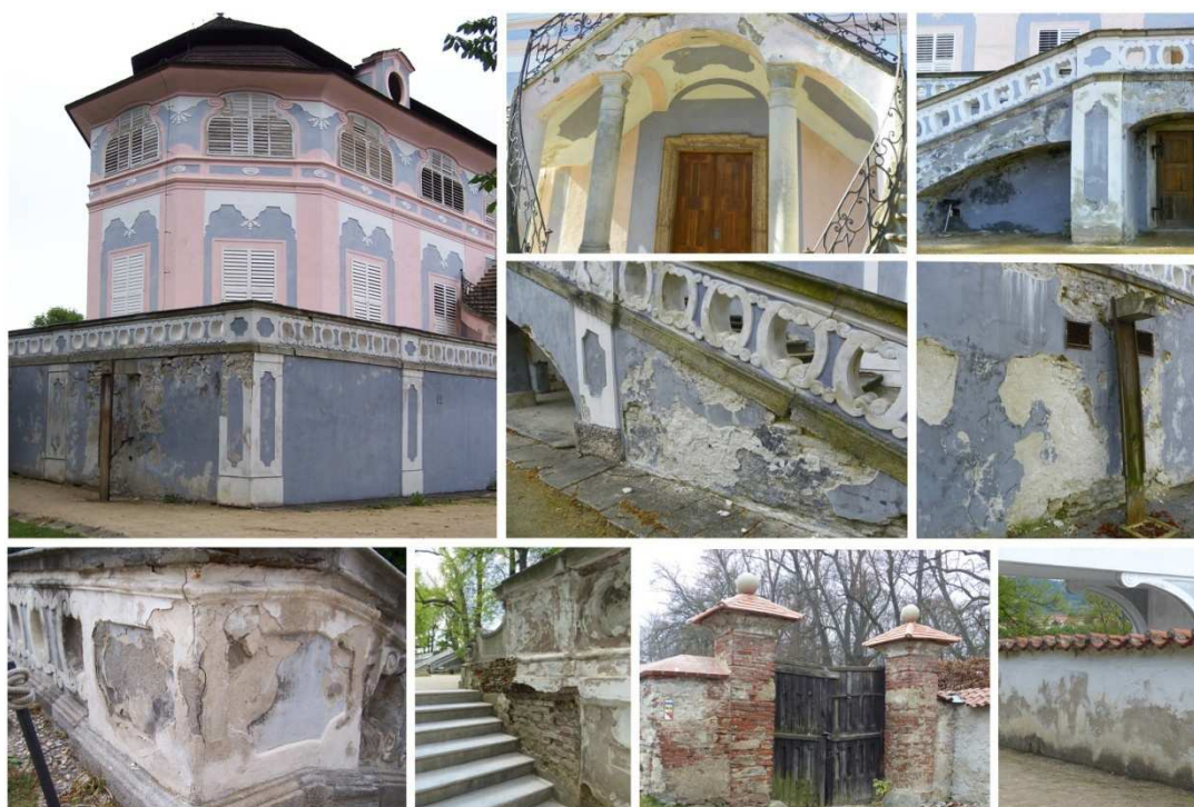
Obr. č. 21 Nedostatečná péče - přirozená degradace konstrukcí a materiálů (zdroj: Archiv zámku Český Krumlov)
