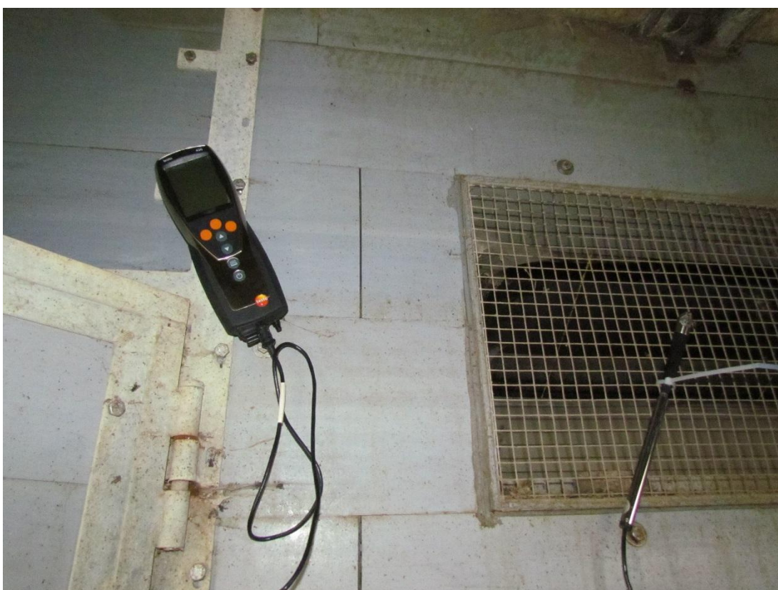
Obrázek č. 9: Foto umístění přístroje TESTO 435
