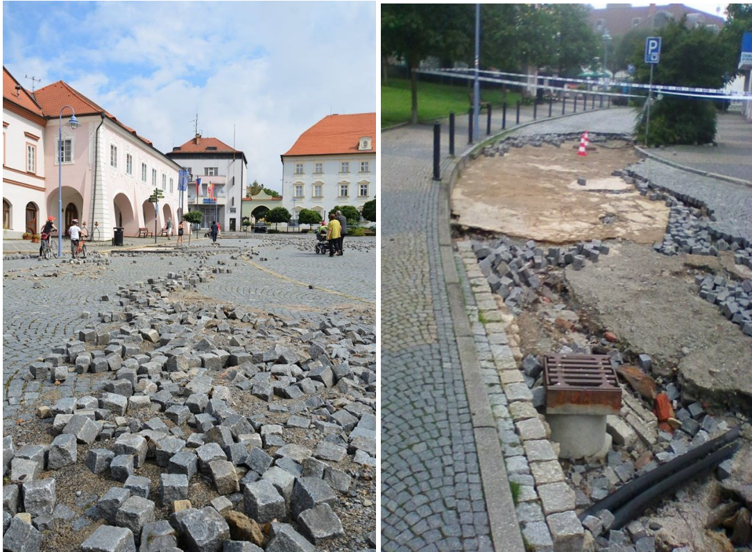
Obrázek č. 27: Následky po přívalových povodních, červenec 2016, zdroj: archiv Městský úřad Týn nad Vltavou
