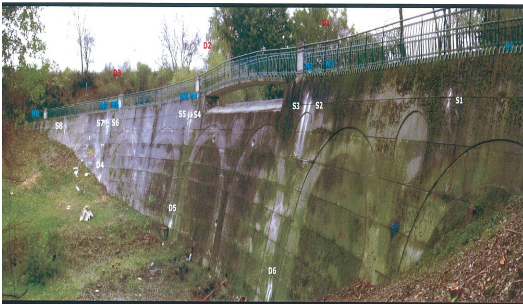
Obrázek č 5: Retenční nádrž, zdroj: Etapová zpráva o TBD prohlídce vodního díla, 2013
