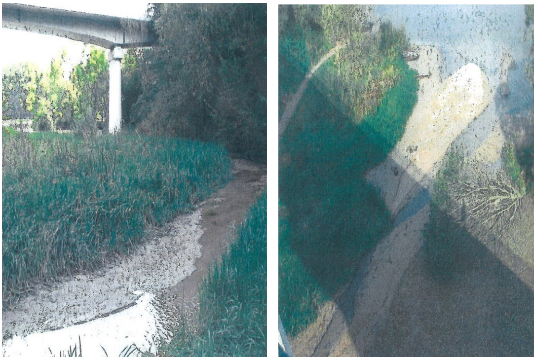
Obrázek č. 11: Foto před realizací odstranění nánosů v zátoce u vodního toku Vltava, prosinec 2014, zdroj: Projektová dokumentace – opevnění koryta Neznašov, Povodí Vltavy s.p.
