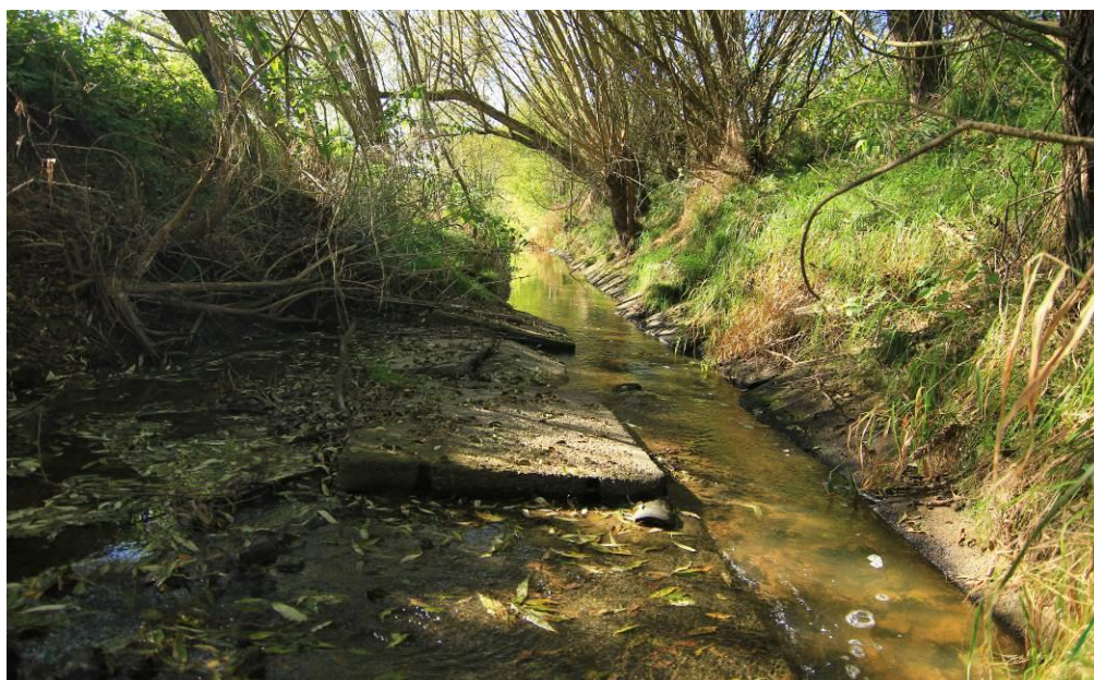
Fotografie. č.12 – poškozené opevnění koryta a břehová eroze, zdroj: vlastní
