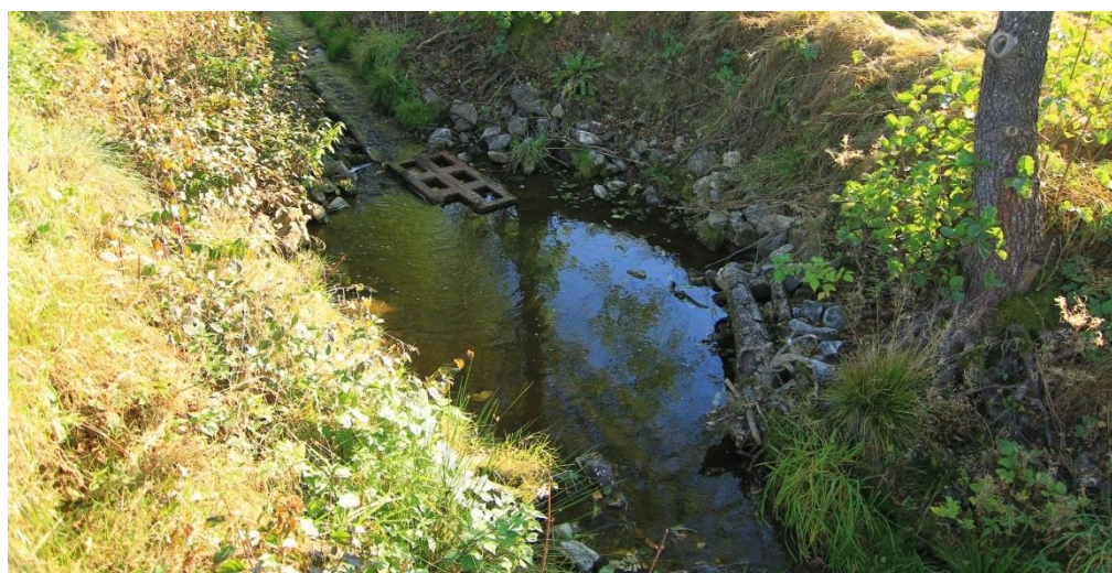
Fotografie. č.19 – Prohlubeň na korytě v úseku 6, zdroj: vlastní
