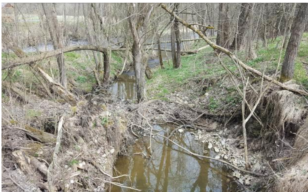
Fotografie č. 11 – poškozené a zanesené koryto před ústím do řeky, zdroj: vlastní
