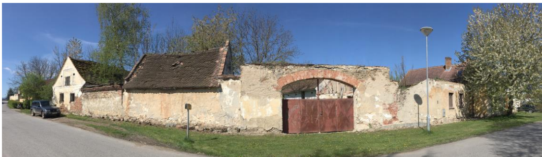
Obr. č. 36 Chátrající stavení čp. 1 a 2 v obci Vlhavy (Zdroj: autor)
