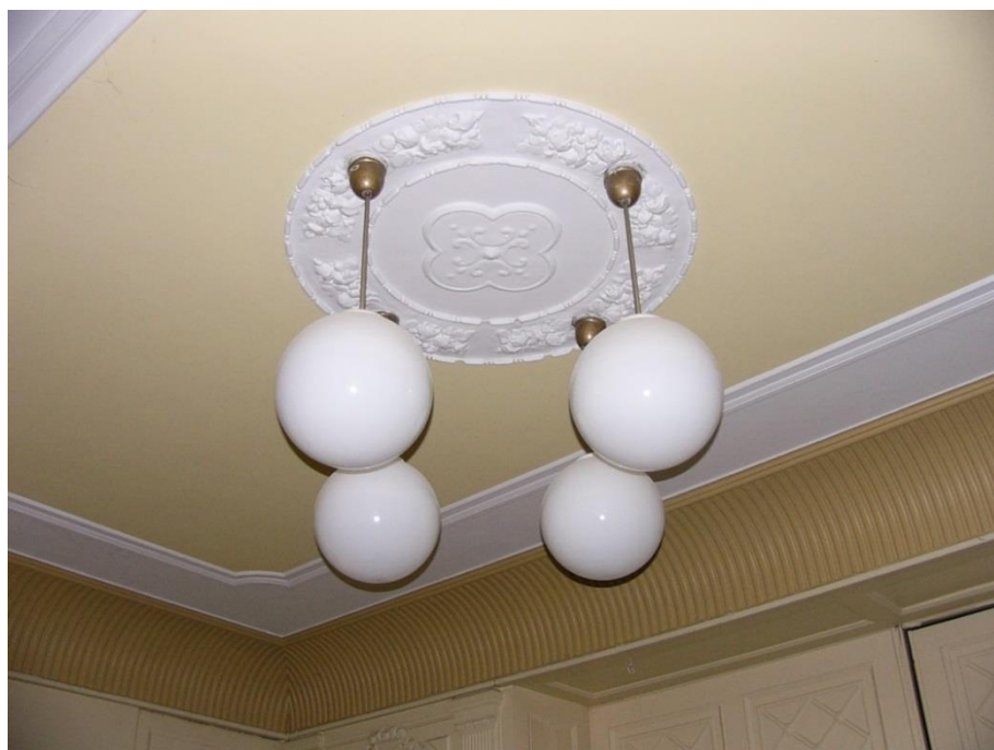
Obr. 47- Strop ve vstupní hale, výrazný fabion, současný stav 2016.
